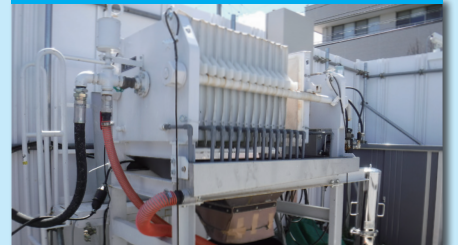
汚水処理機にて汚水の処理 ⑤
